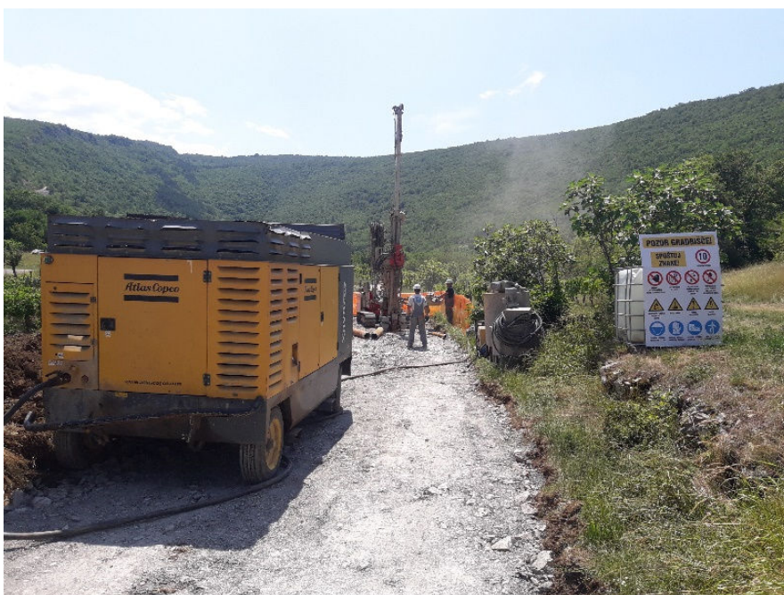
Slika 2. Vrtanje vrtine v prispevnem zaledju Rižane z namenom nadzora in varovanja vodnega vira pitne vode; julij 2019
