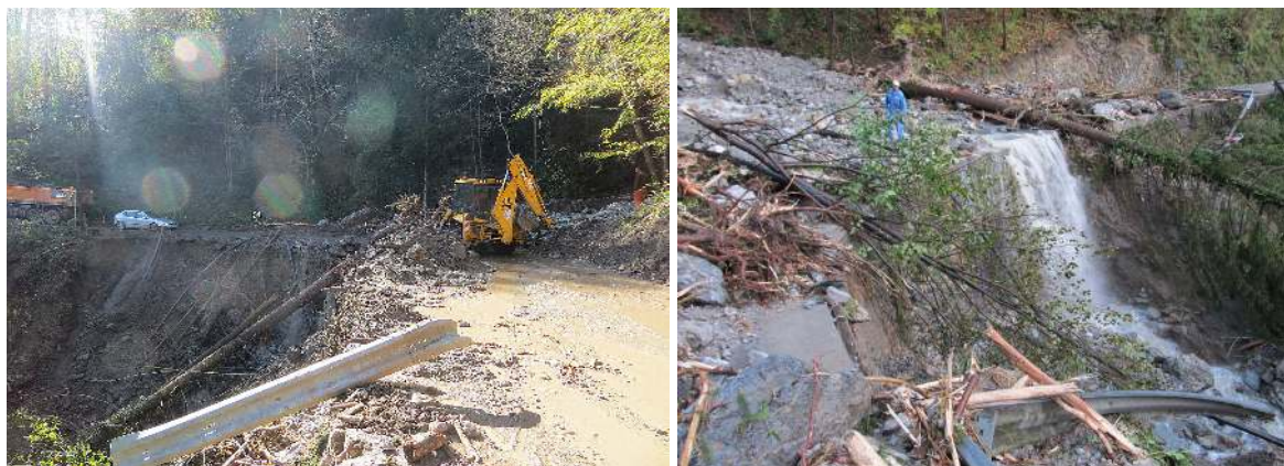
Slika 3. Hudourniške vode so močno poškodovalе ceste v srednjem Posočju (Vir: MMC) Figure 3. The flood damage on roads in Baška grapa (Photo: MMC)
