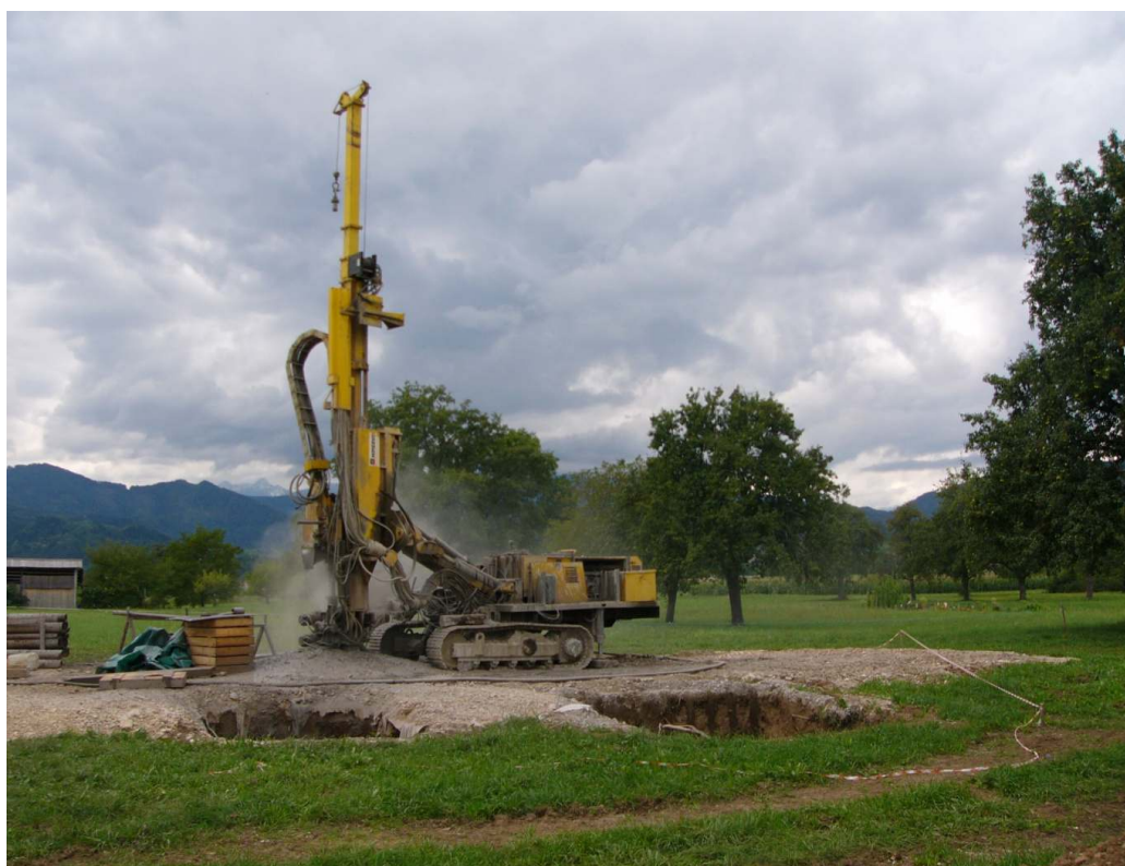
Slika 1. Vrtanje piezometrične vrtine na Bledu v septembru 2013 (foto: V. Savić) Figure 1. Piezometric borehole drilling in Bled, September 2013 (Photo: V. Savić)
