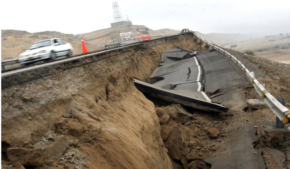
Slika 3. Delna porušitev cestišča na obalni cesti Panamerika v okolici nadžarišča Figure 3. Partial collapse of the roadway on coastal road Panamerica in the neighbourhood of epicentre
