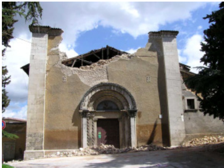
Slika 4. Ena izmed številnih poškodovanih cerkva v L'Aquili (foto: I. Cecić) Figure 4. One of the many damaged churches in L'Aquila (Photo: I. Cecić)
