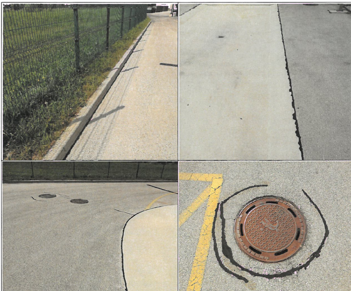
Slika 49: Primeri sanacije zunanjih utrjenih manipulativnih površin z zalivanjem s trajno-elastično polimerno bitumensko zalivno maso [39]
