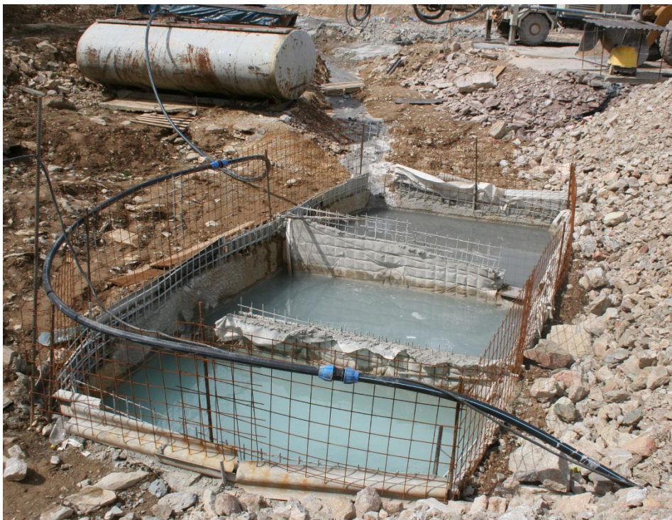
Slika 6-3: Primer izvedbe usedalnih bazenov
