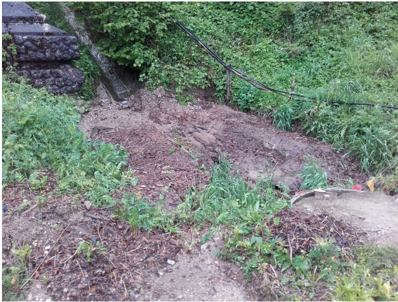
Slika 2-11: iztok iz portalne kanalete ob večjih deževjih (vir: SŽ Infrastruktura)
