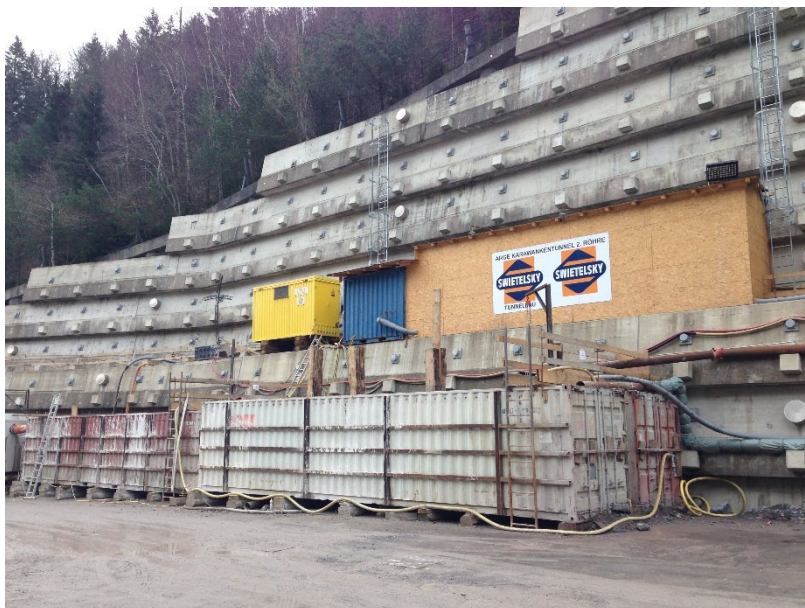
Slika 6-4: Primer sestava začasne čistilne naprave na severnem portalu gradbišča cestnega predora Karavanke
