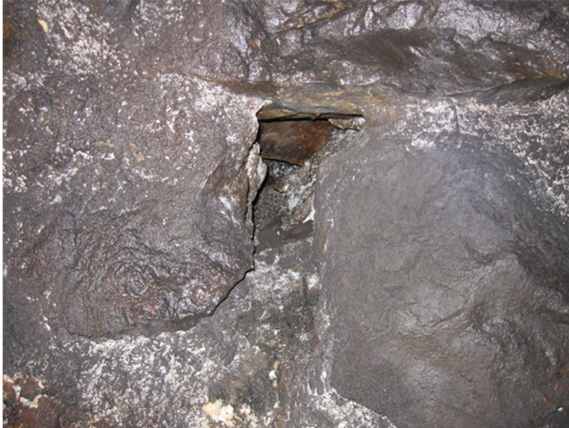
Slika 2-1: odprtina v oblogi predora za iztok hribinske vode
