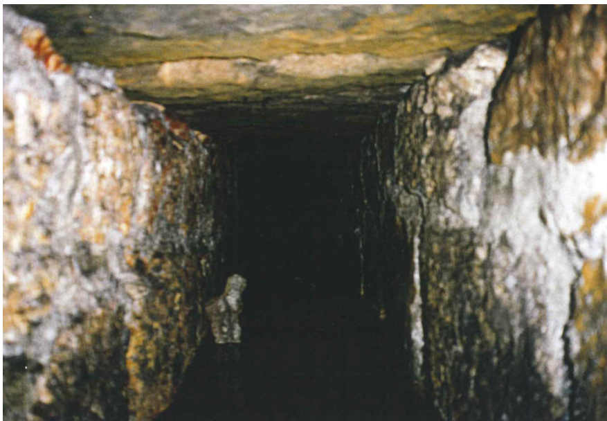
Slika 2-3: stanje zidanega kanala
