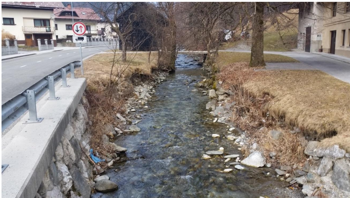
Slika 9: Poškodbe brežin (odplavljena obrežna zavarovanja) na območju domačije Češnjica 20.
