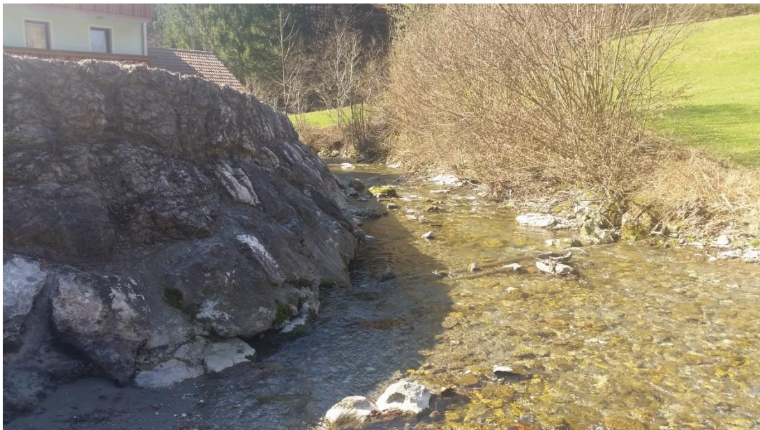
Slika 2: Spodkopana zložba iz lomljenca v betonu. Krono je potrebno povezati z zaledjem.
