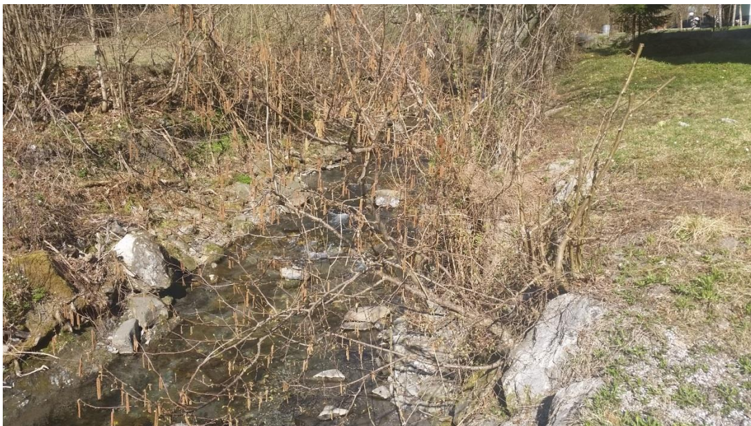
Slika 3: Preozek profil, poškodbe desne (na sliki leve) brežine.
