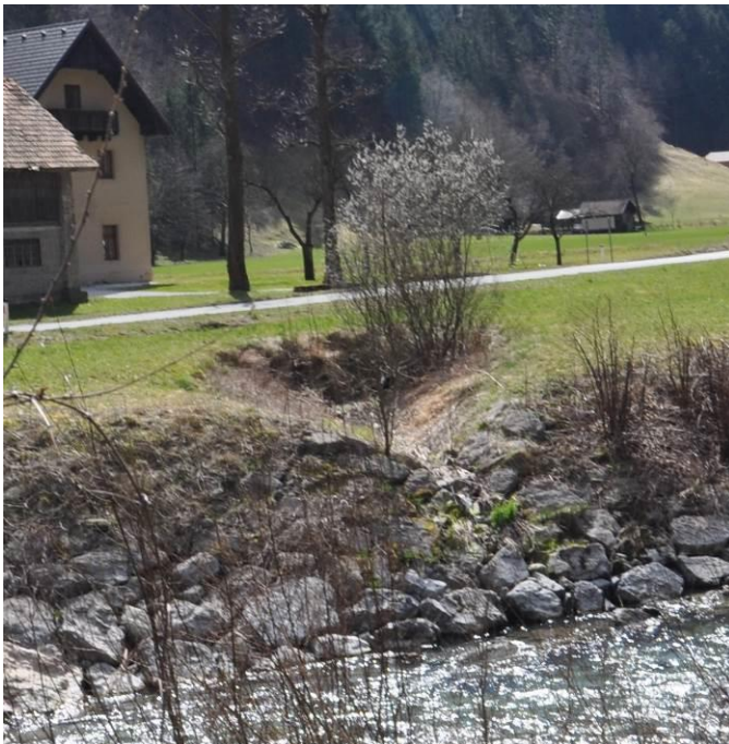
Slika 11: Izpust meteorne kanala na območju pr. 152
