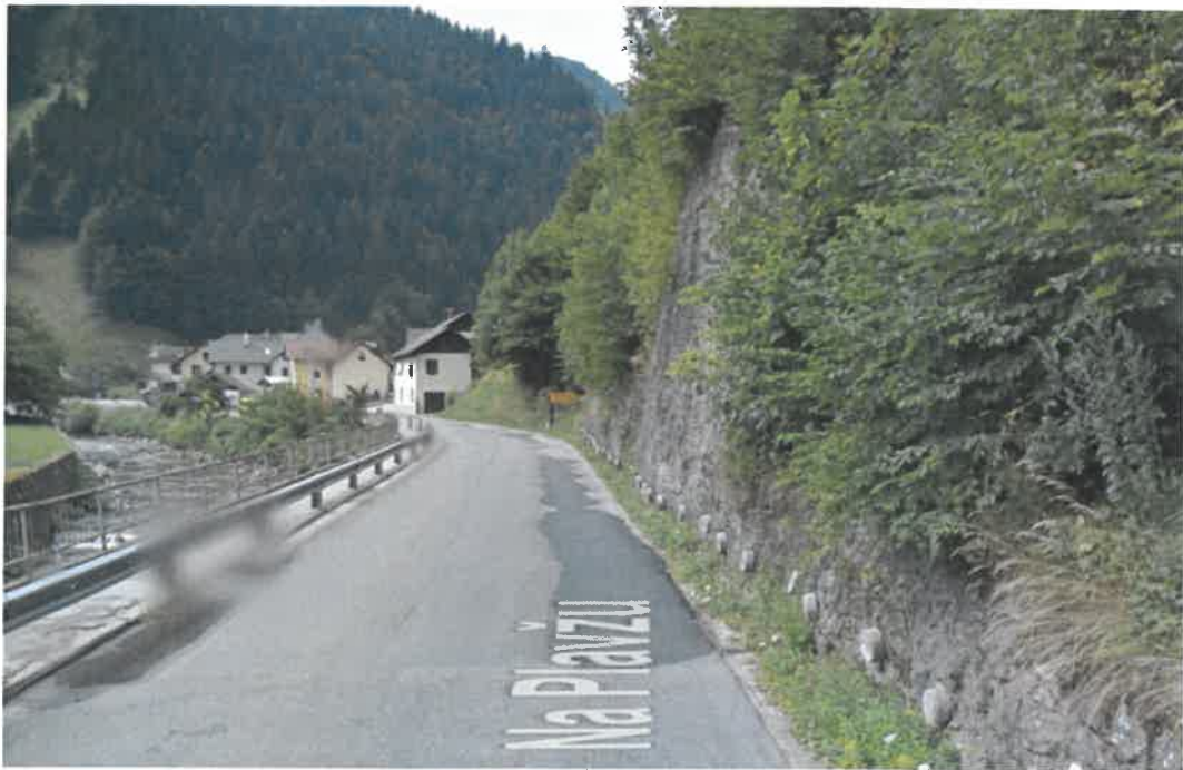
Odsek trase v km 8+580 (P48), kjer je obstoječa VK v slabšem stanju, izdelane so lokalne preplastitve. Na spodnjem delu slike viden začetek odseka v dobrem stanju. Pogled v smeri Železnikov (v smer padanja stacionaže).
