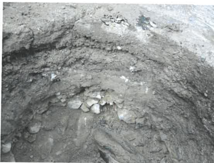
Detajl jaška J-2 in pogled na nehomogeno sestavo voziščne konstrukcije (km 7+875).
